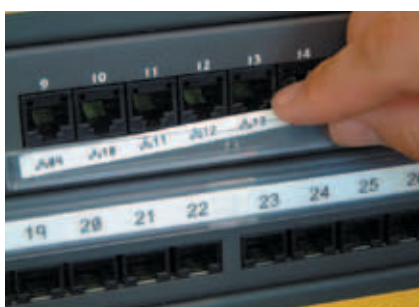
Маркировка монтажных блоков & патч-панелей
